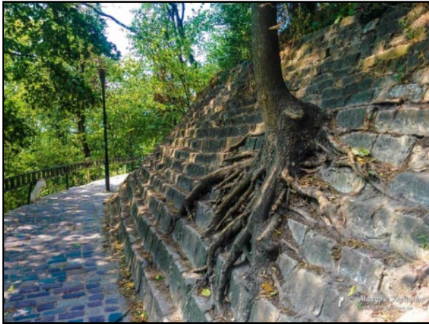
Рис. 11. Прокладена по терасованому схилу кургану доріжка і збудована вздовж неї підпірна стінка Fig. 11. A path laid along the terraced slope of the mound and a retaining wall built along it
