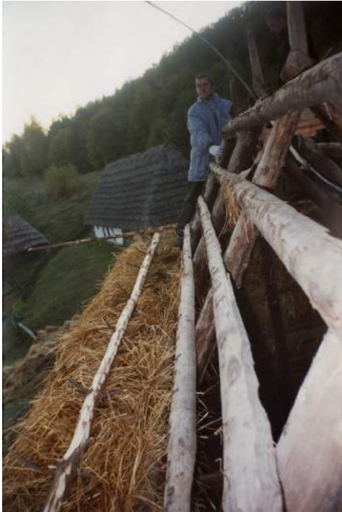
Фото 31: Фрагмент даху млина зі с. Пилипця Міжгірського р-ну Закарпатської обл. Процес покриття даху соломною “внатрус”. Реставрація 2006 р., НМНАПУ, м. Київ. Фото М. Матійчука
