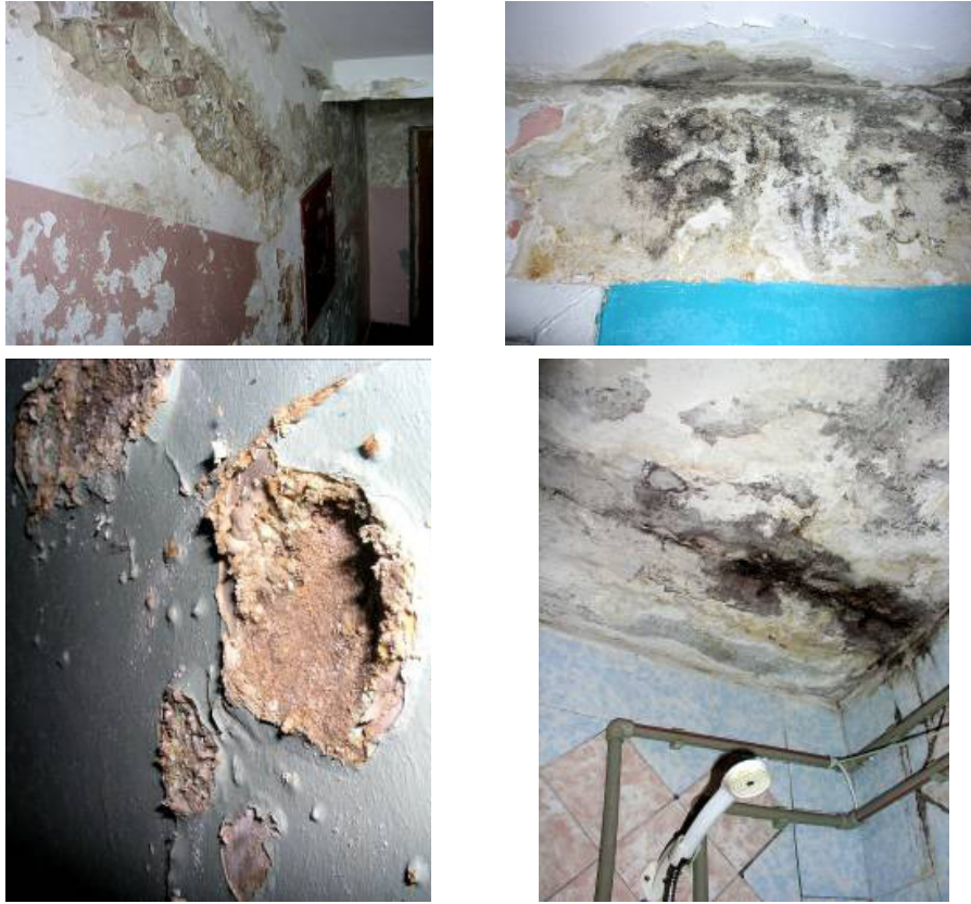
Рис. 1. Приклади ушкоджених стін у обстежених приміщеннях.
